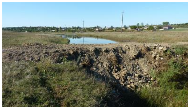
Im.61: ultimul din seria de baraje din satul Biliceniei Vechi (r-nul Sângerei). Se observă diferența nivelurilor, lipsa scurgeri și faptul că după baraj râul – Ciulucul Mare – demult n-a curs.
